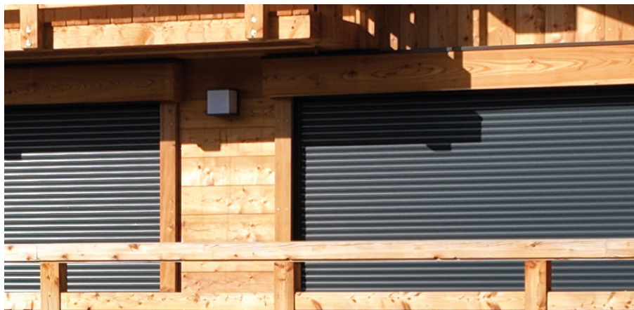
Menuiseries, garde-corps et platelage en bois
